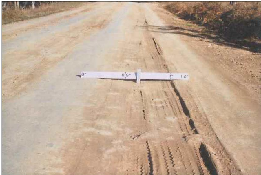
Figura N°71: Ahuellamiento en la superficie de rodadura
