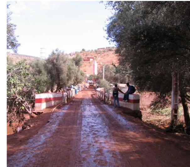
Mauvais état des routes et des pistes en zone de montagne
