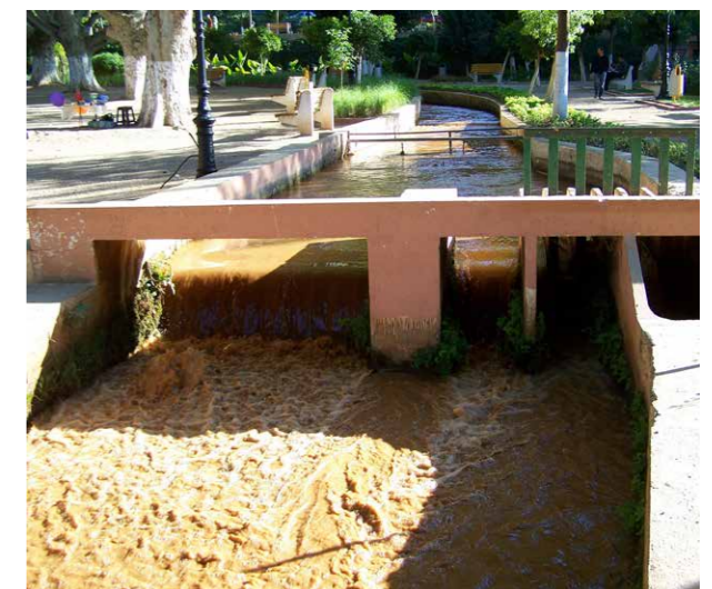
Peigne de répartition des eaux de Aïn Asserdoune
