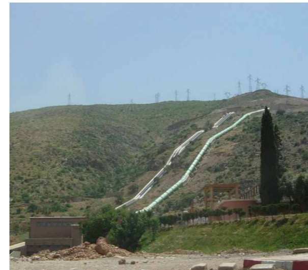
Canalisation de transfert d'eau d'Afourer
