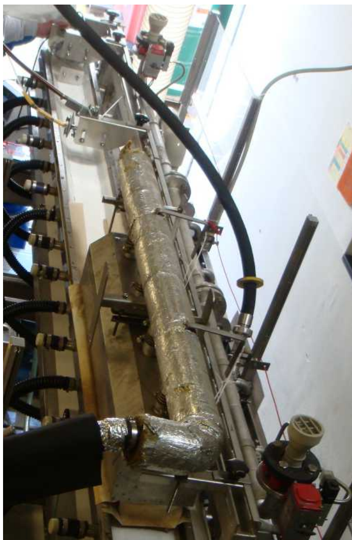
FIG. D.2: Photographie de l'ensemble du filtre.
