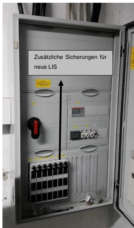
Abbildung 5: alter Unterverteiler nach der Installation der neuen Ladesäulen
