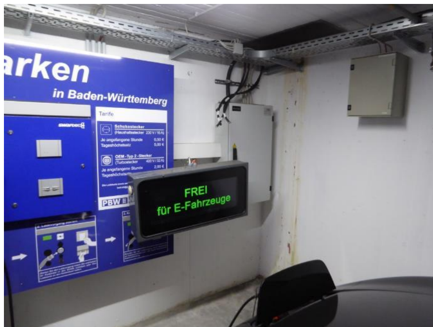
Abbildung 6: alter Unterverteiler für die Ladesäulen - Einbausituation
