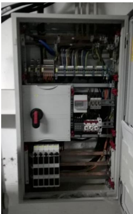
Abbildung 4: alter Unterverteiler vor der Installation der neuen Ladesäulen
