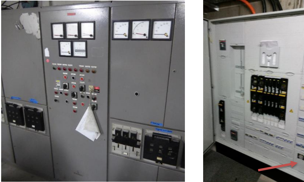
Abbildung 3: alter Hauptverteiler links und neuer Hauptverteiler rechts
