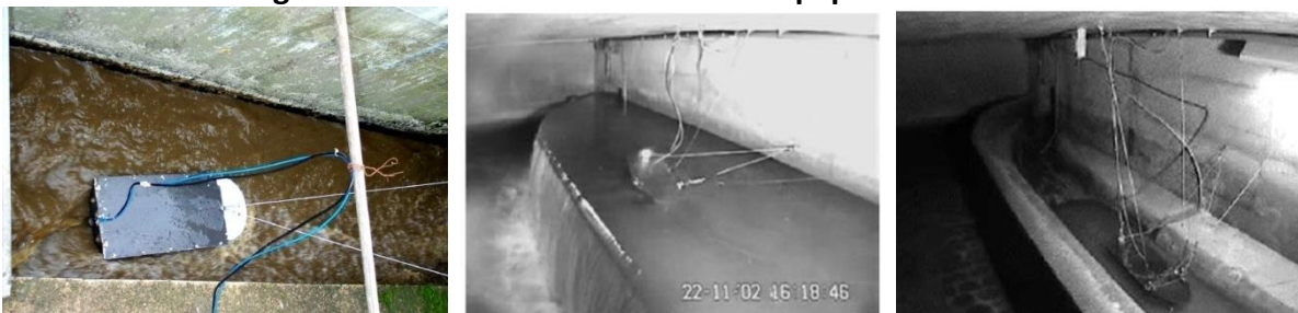
Figura 31 Vista de la instalación del equipo de medida.
