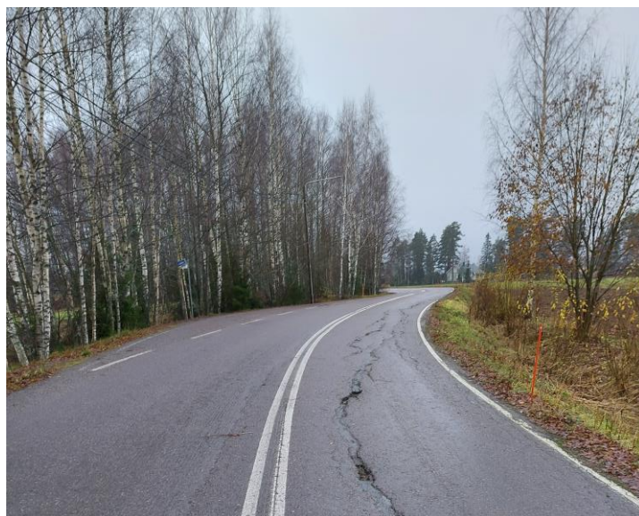
Kuva 28 Pituussuuntaisia halkeamia Kolistimentillä
