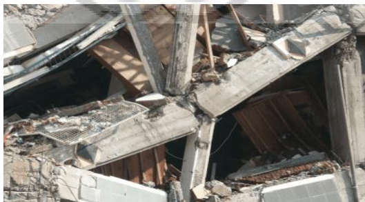
Gambar 1.4 Kegagalan Beam-Column Joint dan Pasca Gempa Asia Tenggara 2004 (Sumber: Ghobarah, dkk., 2006)
