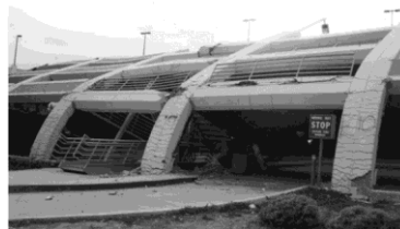
Gambar 1.1 Struktur Bangunan Parkir yang Runtuh Akibat Gempa Northridge Pada Tahun 1994 (Sumber: Erdey, 2007)
