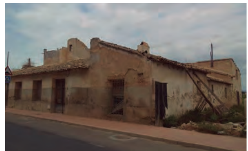
Imagen 48. Evidencia del deterioro del paso del tiempo. Casa de Concha García García en La Puebla. 2018. Foto de elaboración propia. .
