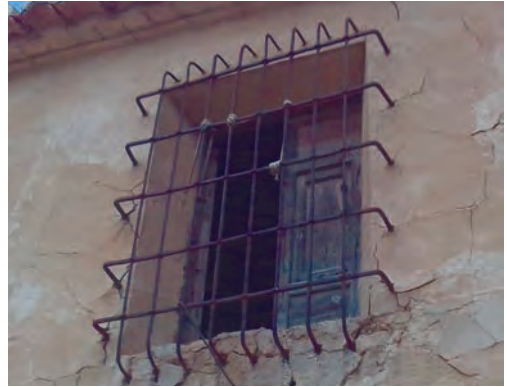
Imagen 42. Reja sobresaliente del muro. 2018. Foto de elaboración propia.
