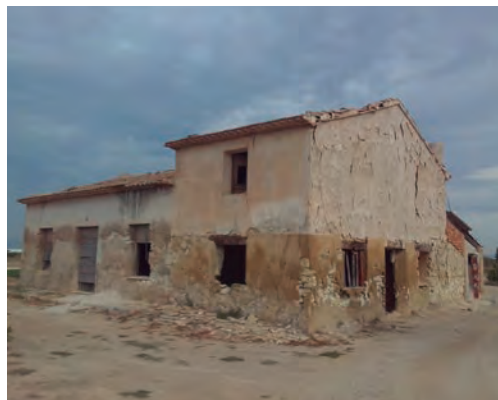
Imagen 17. Efectos del paso del tiempo en una vivienda de la huerta. Casa de la tía Sinforosa . 2018. Foto de elaboración propia.
