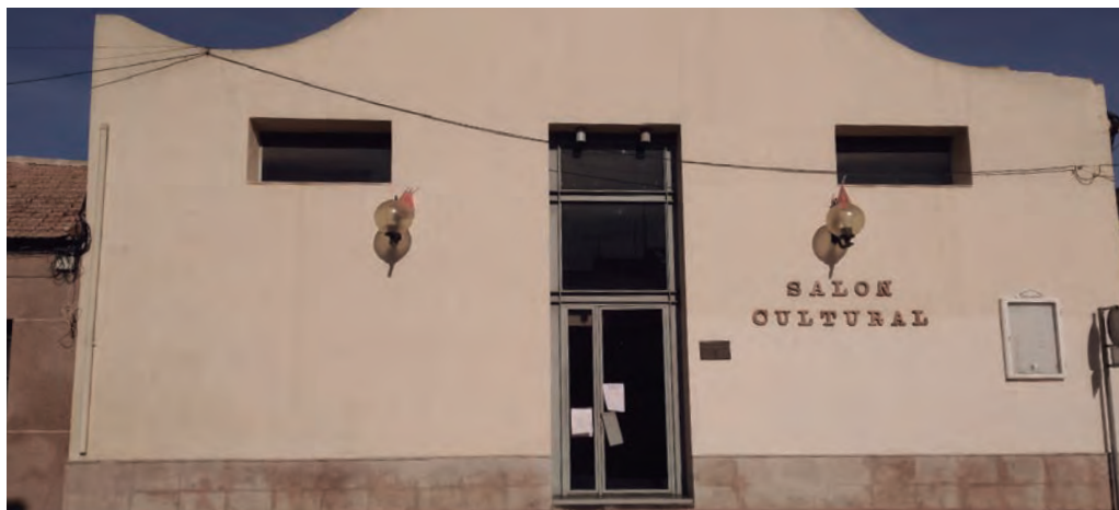
Imagen 41. Caída de parte de la fachada del Salón Cultural. 2015. Foto de elaboración propia.
