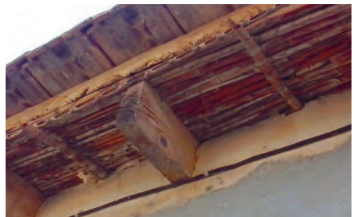
Imagen 33. Cornisa con alero de madera y cañas. 2018. Foto de elaboración propia.
