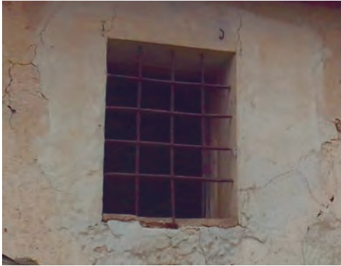
Imagen 41. Reja en retícula colocada a mitad del espesor del muro. 2018. Foto de elaboración propia.
