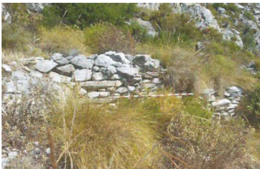
Fig. 20: mampostería ordinaria a hueso irregular y semi-irregular de los Castillejos Fuente: Proyecto PIMALBORÁN 228
