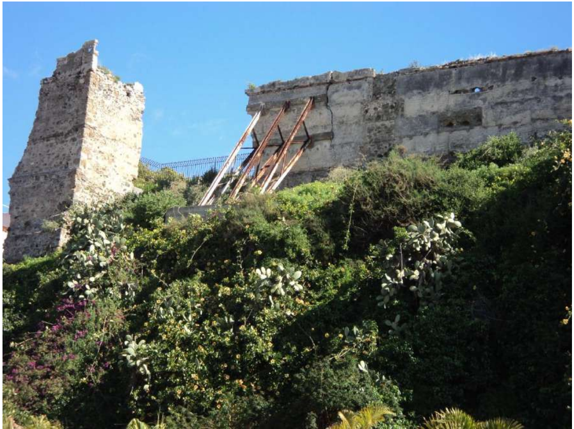
Fig. 18: tapial calicastro con hiladas de ladrillo y de mampuestos con separación de ripios y con grandes sillares en la esquina de la torre sobre el Majuelo Fuente propia
