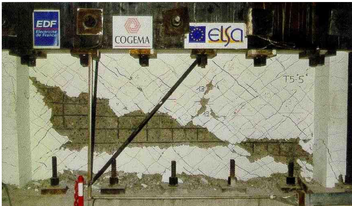
Figure IV-1 : Photo du voile en béton armé T5 des essais SAFE dans un état de ruine à la fin de la sollicitation sismique la plus endommageante (0.9g). Rapport d'essai JRC.
