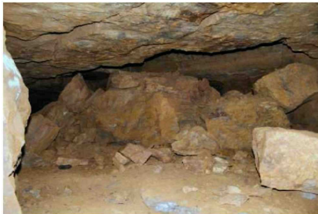
Fig. 1 : Chute de bloc dans la zone à risque d'effondrement de l'ancienne mine de fer de Moyeuve-Grande (54).
