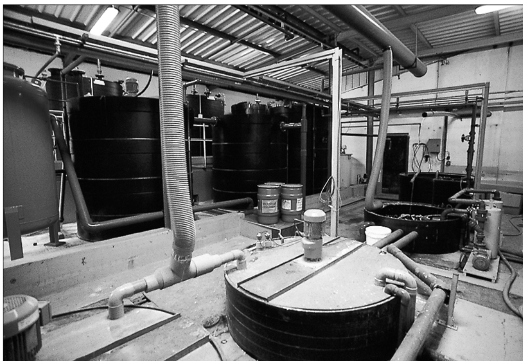
Station de détoxification de traitements de surface.
