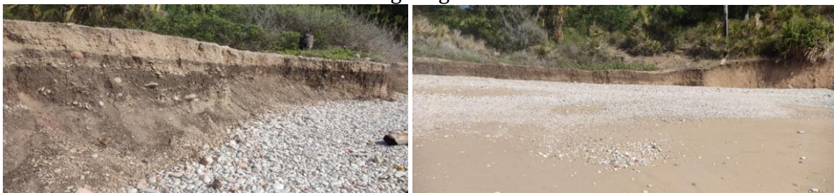
Gambar 2. Indikasi Kerusakan Pantai Abrasi dan Erosi Pantai
