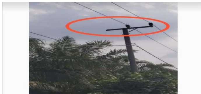
Gambar 3 Tiang Listrik yang rusak.
