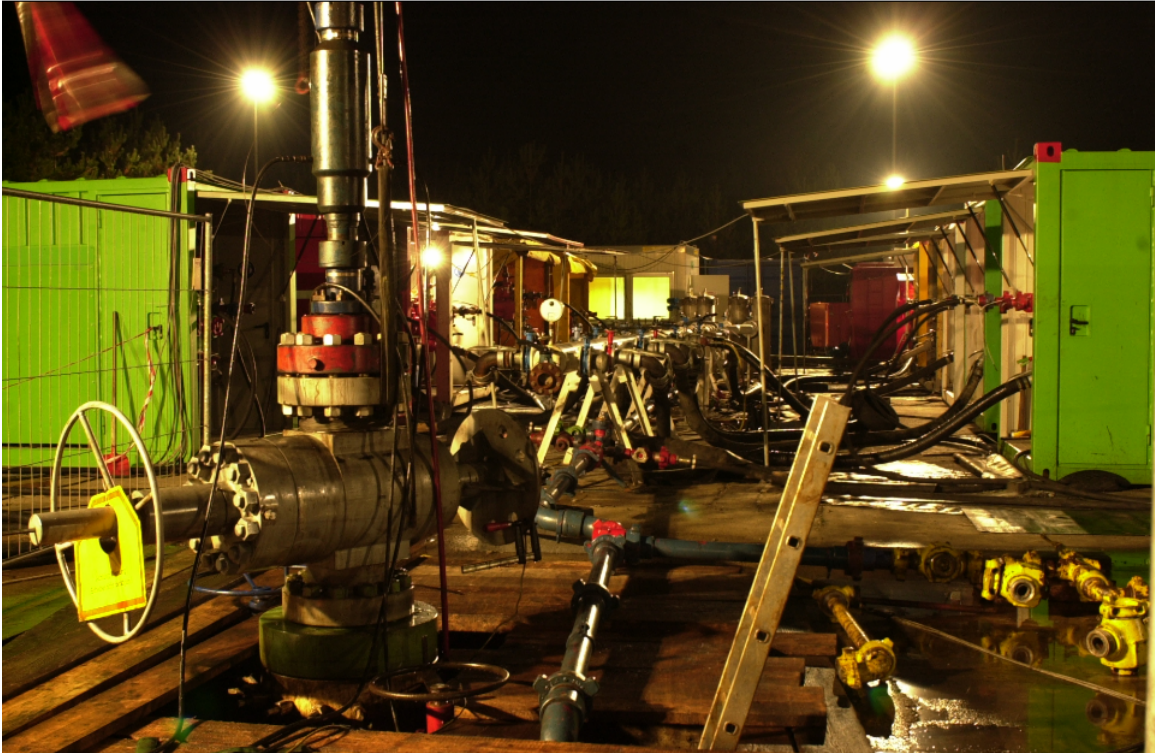
Abb. 8: Bohrlochkopf und Hochdruckpumpen während eines massiven Wasserfrac-Tests in der Bohrung Horstberg Z1.
