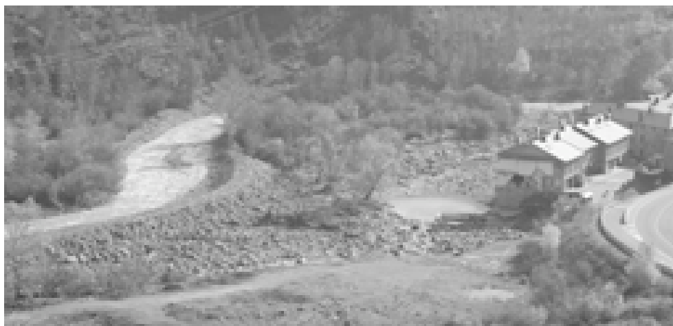
Figura 18. Primera fase de trabajos ya realizada por la C.H.E. (fotografía tomada el 15 de noviembre de 2012) en Castiello de Jaca. A la izquierda se observa el nuevo cauce abierto, más alto y jalonado por una elevación de tierra. A la derecha, al pie de los unifamiliares se conserva el cauce de la crecida, que en la siguiente fase de la actuación será totalmente rellenado de materiales extraídos del río.
