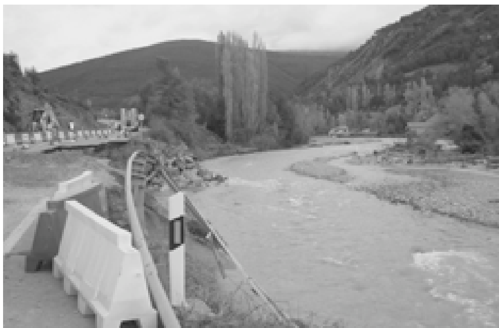
Figura 13. Desperfectos en la carretera N-330 a raíz de la erosión del talud por la crecida del río Aragón aguas abajo de Castiello de Jaca.
