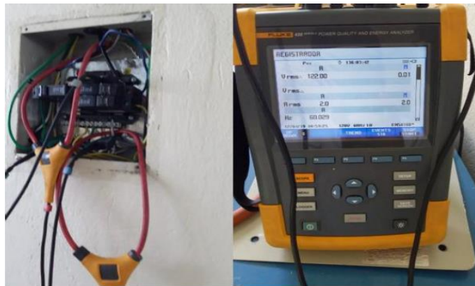
Fig. 12. Analizador de carga Fluke 435 [20].
