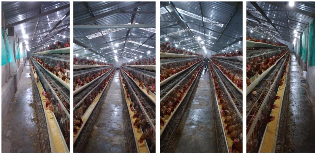
Figura F. 3. Prueba de funcionamiento del sistema de Fumigación
