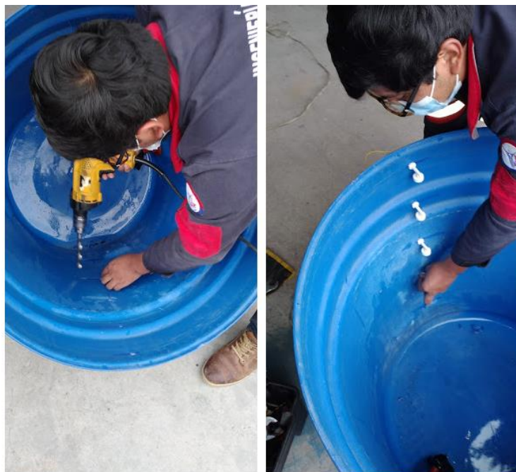
Figura D. 1. Instalación de los sensores de nivel ZPC1
