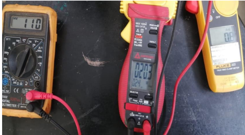
Figura R.2. Valores obtenidos en la prueba en vacío en el autotransformador.
