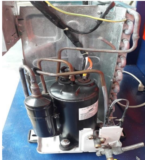
Imagen 1. Condensador y motor compresor de Split.
