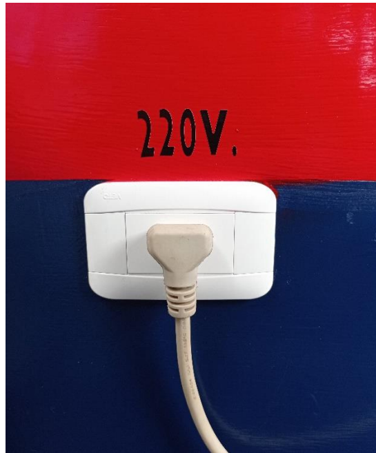
Imagen 24 Conector pon punto eléctrico Fuente: Giler Henry (2021)
