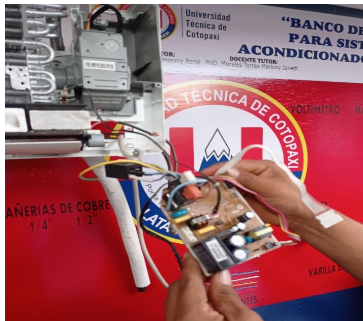
Imagen 21 Ubicación del panel control en el acondicionador tipo Split Fuente: Giler Henry (2021)
