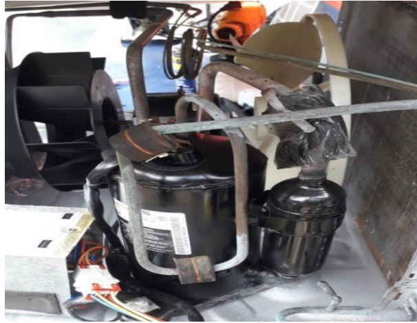
Figura 24. Desarmado del acondicionador tipo ventana Fuente: Giler Henry (2021)
