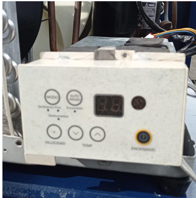
Imagen 18 Ubicación e identificación del panel de control tipo ventana Fuente: Giler Henry (2021)
