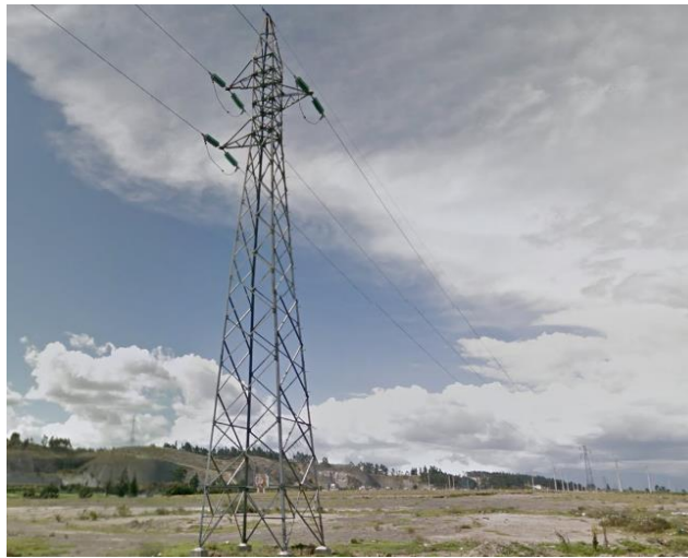
Figura 5.12. Torre de transmisión 138 kV.
