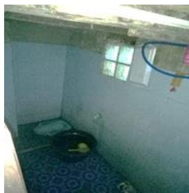
Gambar 2. Kondisi Kamar Mandi Sumber: Dokumentasi pribadi, 2021
