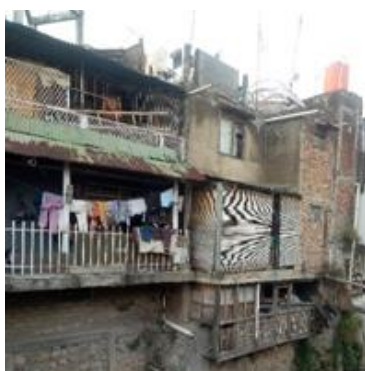
Gambar 1. Kondisi dinding yang saling menempel membuat jarak antar bangunan tidak ada sama sekali Sumber: Dokumentasi pribadi, 2021
