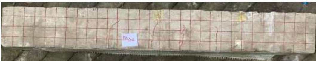
Gambar 12 Pola retak pada balok perkuatan GFRP-S tulangan normal
