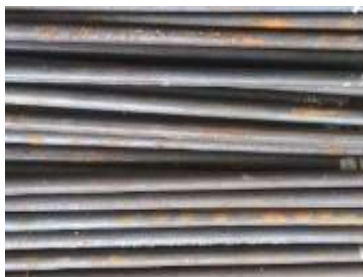
a. Tulangan belum terkorosi
