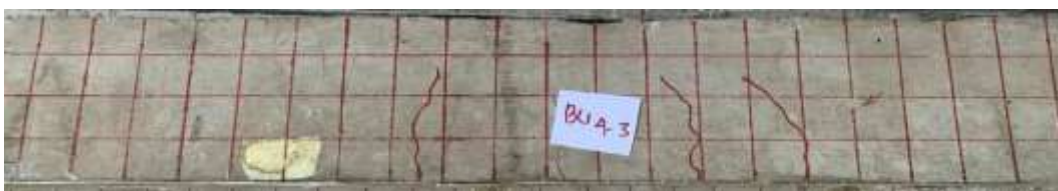
Gambar 14 Pola retak pada balok perkuatan GFRP-S tulangan korosi 4 minggu
