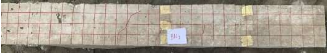
Gambar 11 Pola retak pada balok tulangan normal
