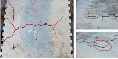
Bild 23: Rissbild in der zentralen Platte (links) und Lösen der Zahnleistenverbindung (rechts) | Fig. 23: Crack pattern in the central plate (left) and loosening of the dry joints (right)
