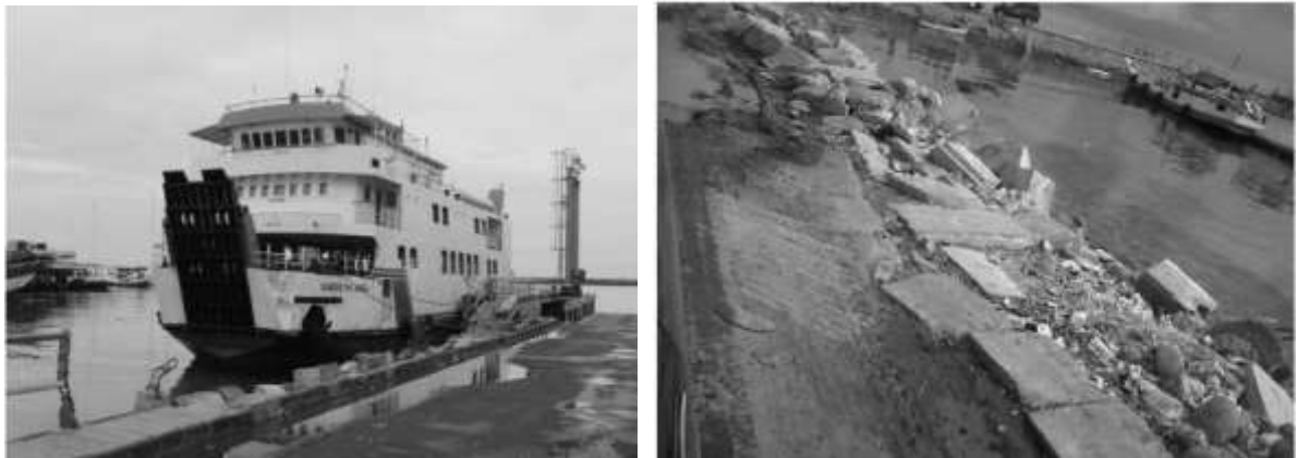
Gambar 1. Kondisi pembatas jalan di Pelabuhan Penyeberangan Ferry Bira Bulukumba
