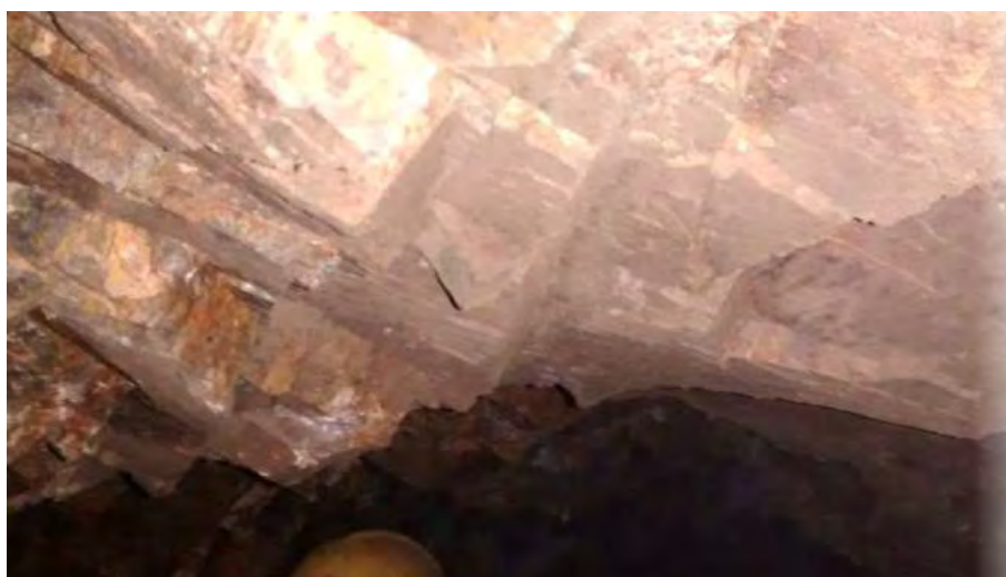
Fotografía N° 14 Disparo fallado (Desquinche) en Ch 780
