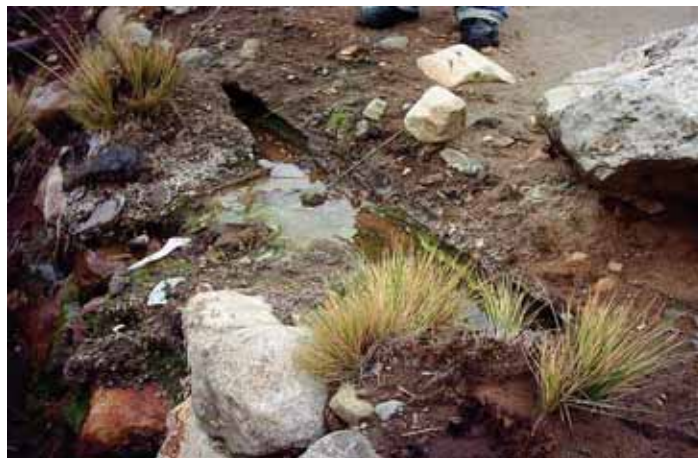
Foto 15: Desagüe discurriendo a través de tubería de alcantarillado rota
