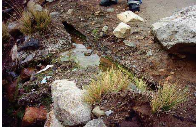
Foto 7: Desagüe discurriendo a través de tubería de alcantarillado rota
