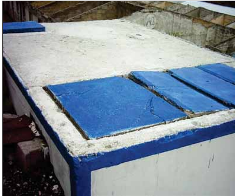
Foto 9: Reservorio de concreto que abastece al Hotel y Comedor
