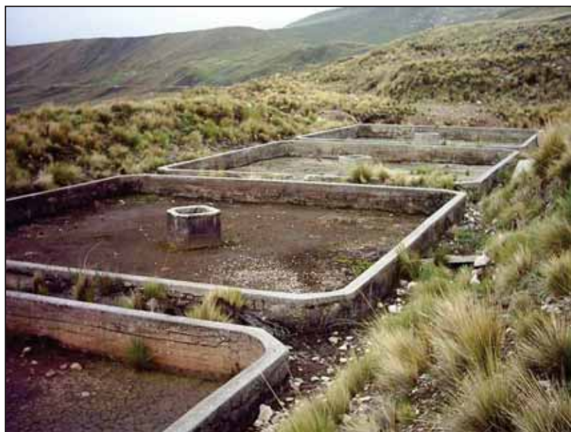
Foto17: Estructuras de lechos de secado de lodos
