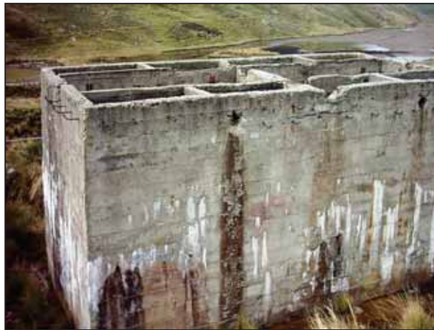
Foto 16: Estructura de concreto del tanque séptico en condiciones deterioradas
