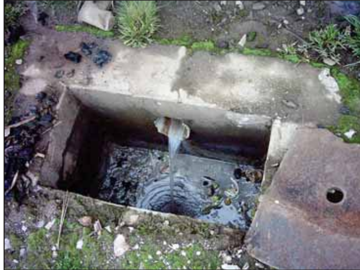
Foto 13: Caja de registro del colector de desagüe
