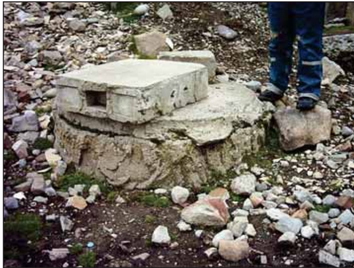
Foto 14: Estado de deterioro del buzón de alcantarillado
