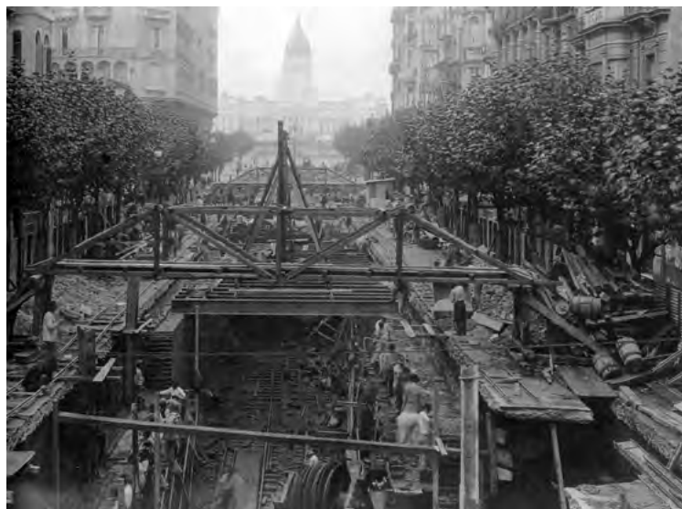
Figura 7. “La ciudad destripada”. Excavación Línea A, método “a cielo abierto”. Fuente: Gutman, 1999.
