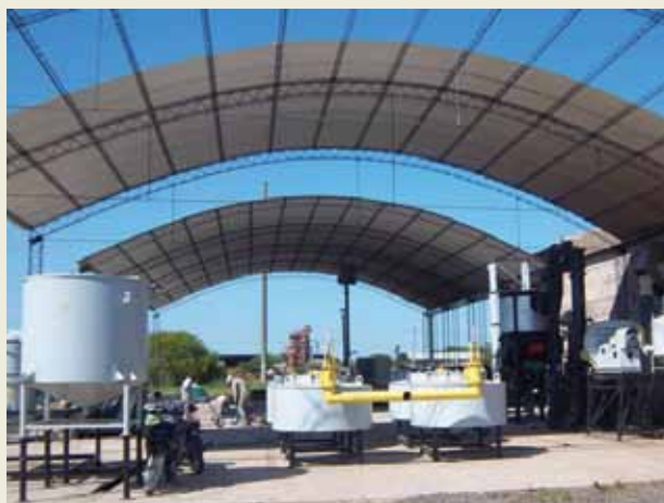
Vista de los filtros del gasificador (centro) y del equipo principal (der. atrás).
