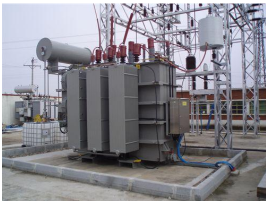
Fig. 15 Transformador de 25MW
