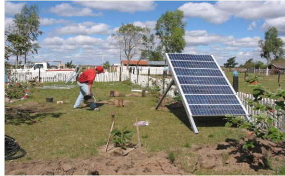
Fig. 6: un sistema fotovoltaico rural
