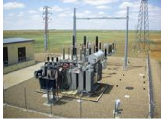
Fig. 16: Sub estación de 40MW
