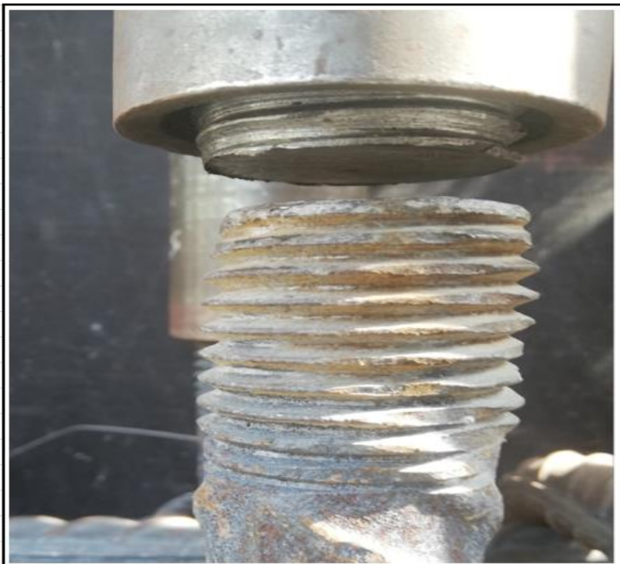
FOTO 10: Empalme con 5mm de luz entre barras
