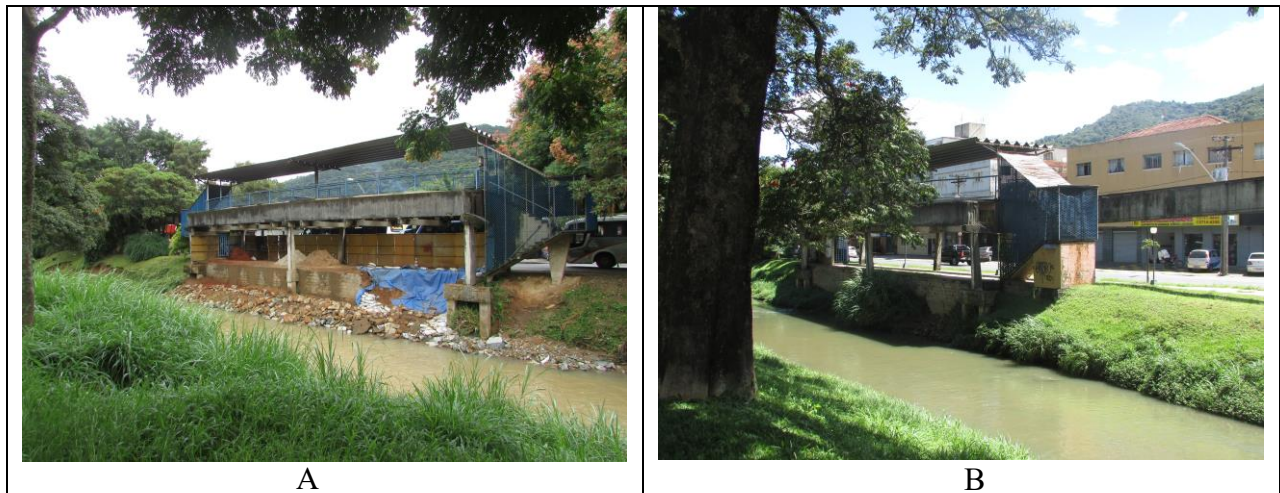
Figura 4 A e B – Margem direita do ribeirão dos Poços atacada por processo de solapamento. O atrito do material carregado nos momentos de cheias exerce pressão sobre as margens justapostas pelo adensamento urbano (A). Posteriormente às cheias, obras de engenharia dão conta de minimizar os danos até que um próximo evento pluviométrico dê oportunidade para os processos descritos acima entrarem em cena novamente (B).
