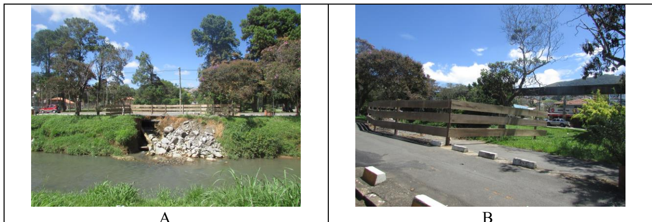
Figura 6 A e B – Confluência canalizada de canal tributário ao ribeirão dos Poços, atingida por processos de solapamento e condicionada à erosão regressiva (A). Nesses termos, os processos em atividade tendem à rápida evolução, com prejuízos aos equipamentos urbanos instalados (B).
