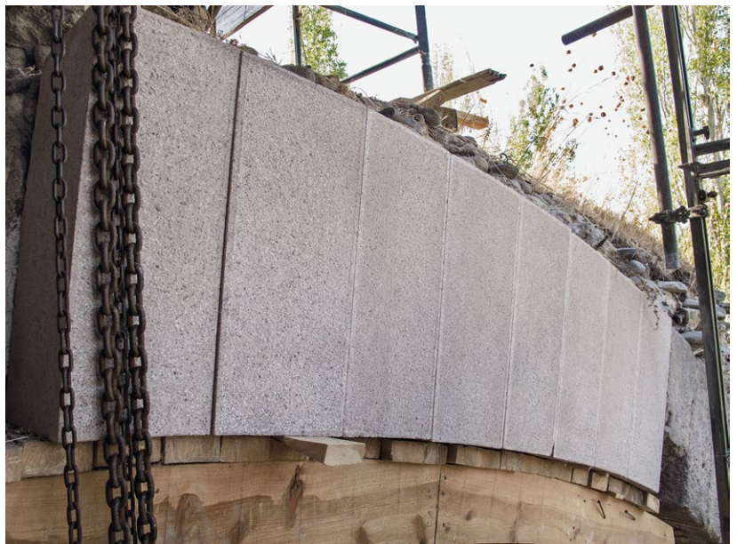
Abb. 83: Rote Halle, Baudenkmalpflege. Ergänzung fehlender Bogensteine am westlichen Strebebogen der südlichen Temenoswand
