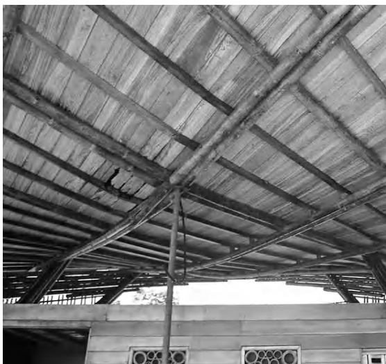
Figura 9. Apuntalamiento provisional de la cubierta por riesgo de colapso en febrero de 2020. Fuente: archivo de los autores
