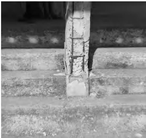
Foto 4. Deficiente separación de estribo. Fuente: autores
