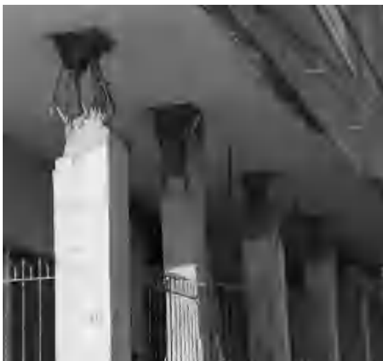
Foto 5. Deficiente separación de estribo en cabeza de columna. Fuente: autores
