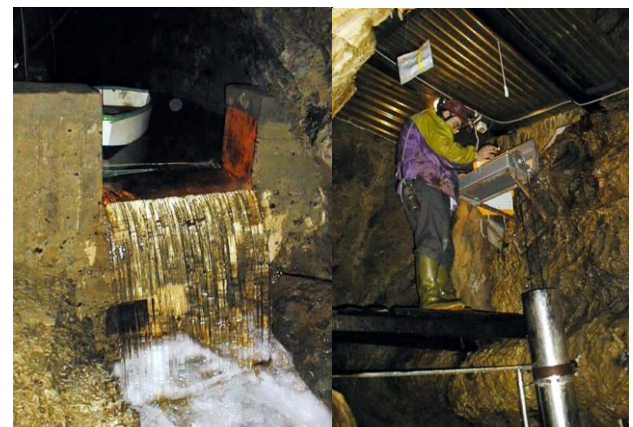
Foto 13 – Lo stramazzo sul collettore ed il vecchio misuratore
