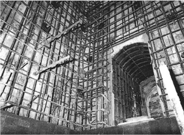
Figura 7. Gabbia metallica della incamiciatura in cemento armato realizzata nel 1985 (da Paolo Rocchi, Torre Civica di San Severino Marche (MC). Relazione Tecnica, 1992).
