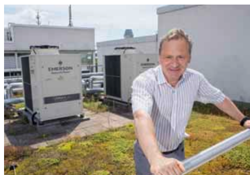
Ob Kälteanlage auf dem Dach, Beleuchtung oder Heizung – Gebäudemanager Olaf Jeutner muss alles im Blick haben.
