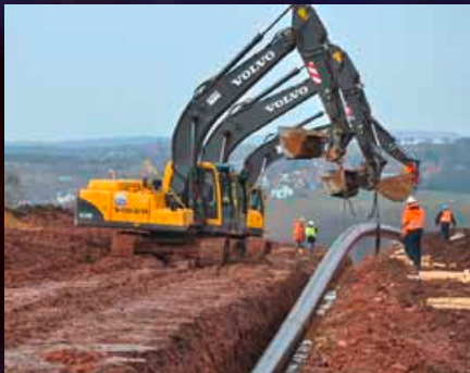
Bau einer Ferngasleitung durchs Erzgebirge – Erdgas-Pipelines transportieren den Rohstoff zu großen Unternehmen und Energieversorgern.
