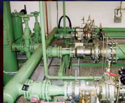
Blick in eine Gasdruckregelstation von ENSO NETZ, die das Erdgas auf die Ortsnetze verteilt.
