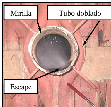
Figura 1. Tubo doblado alrededor de mirilla que presentó agrietamiento y escape de vapor.
