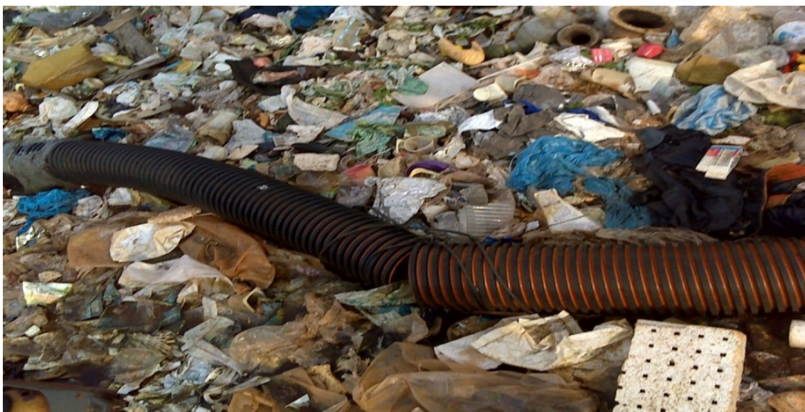
Figura 3- Drenagem do líquido percolado em condições inadequadas.
