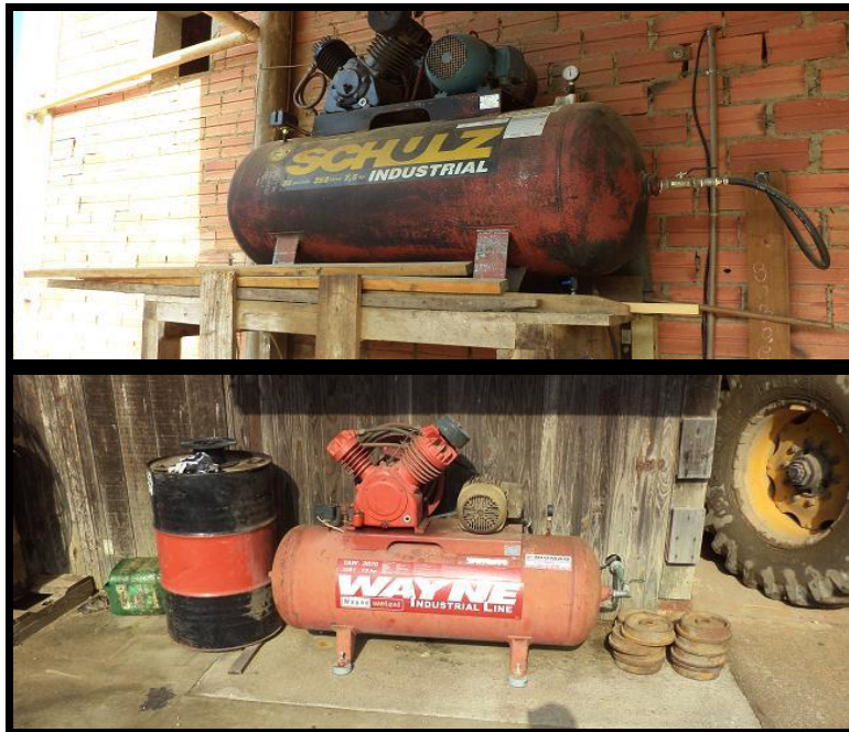
Figura 5 - Compressores sem bacia de contenção.
