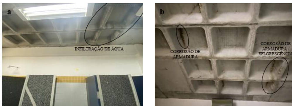
Figura 6. Laje F1 - a) infiltração de água; b) corrosão de armadura e eflorescência.
