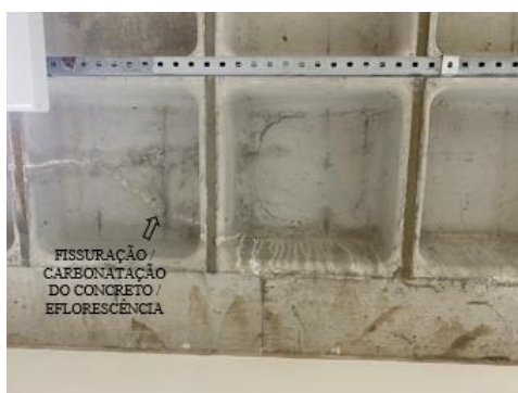
Figura 9. Laje F12 - fissuração, carbonatação do concreto e eflorescência.
