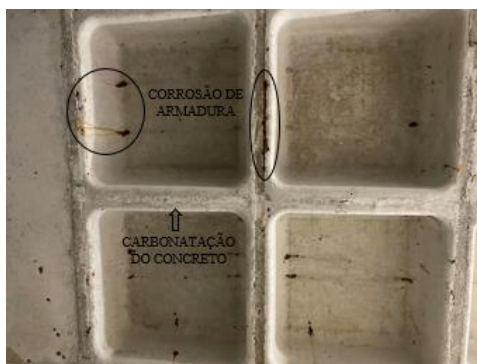
Figura 8. Laje F8 - corrosão de armadura e carbonatação do concreto.
