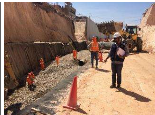
-Control de culminación de relleno con material filtro tramo 2+150 a 2+270 lado Izquierdo de la vía.
