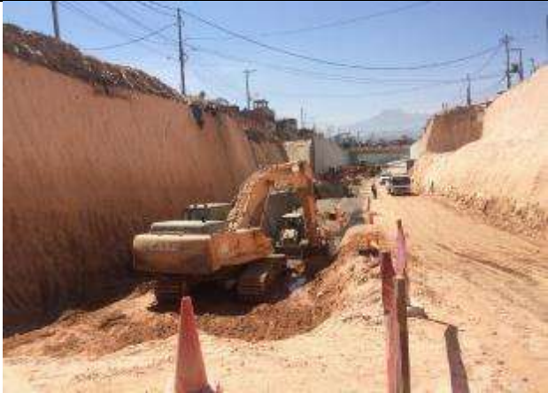
- Verificación de relleno y compactado por capas en corte para colocación de sistema de drenaje de agua subterránea Madre de Dios.
