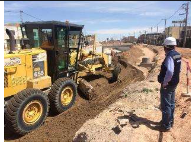
-Verificación de rellenos, conformación, y compactación por capas y compactación en Prog. 1+900 2+100
