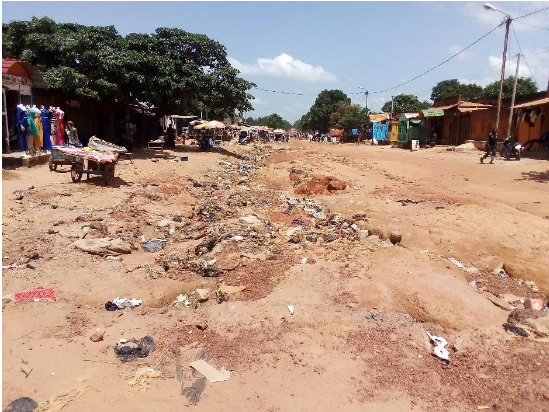
Photo 17: Une rue secondaire (carré) en mauvaise état
