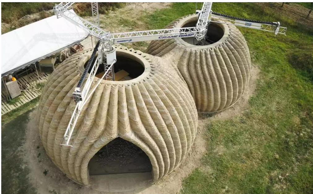
Figura 115: Processo de construção da casa “TECLA” com recurso a uma impressora 3D (Mok [sem data]).
