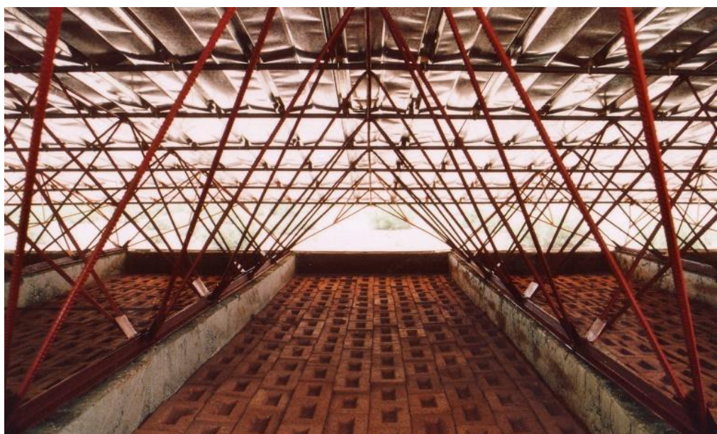
Figura 101: Estrutura de treliças feita através da utilização de barras de aço, onde assenta um telhado em chapa metálica (Duchoud [sem data]).
