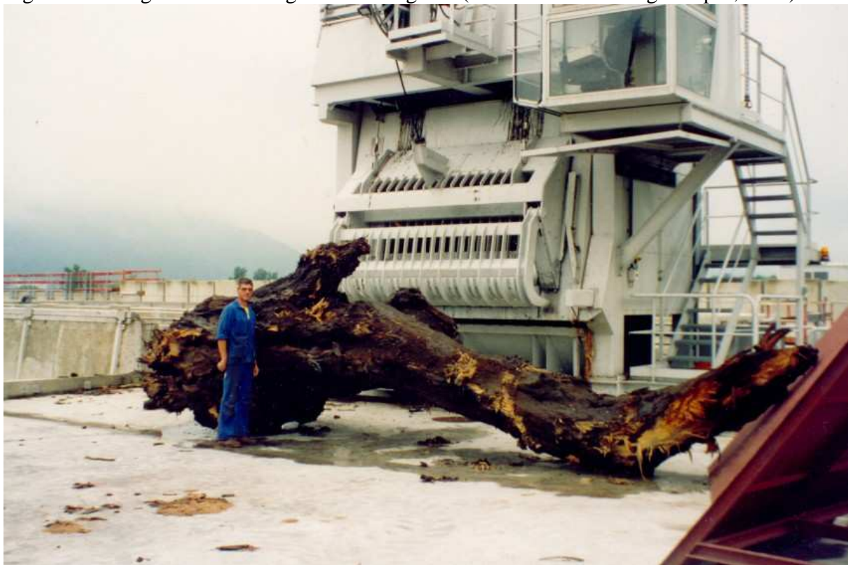
Figure 1. Le dégrilleur du barrage de Saint-Egrève (cliché : E.D.F. Energie-Alpes, 2001).
