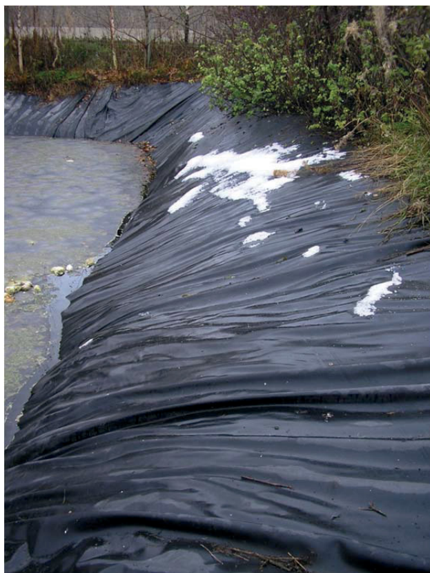
Kuva 1. Puutteellinen rakennusaikainen maanmassojen tiivistys on aiheuttanut penkereen sotumisen. Kuva: Teemu Ala-Kleme
