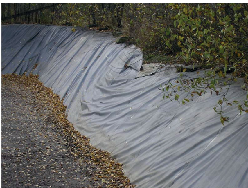
Kuva 7. Tiivistekalvon ankkurointi penkereen yläreunaan on pettänyt ja kalvo irronnut yläosastaan. Kuva: Teemu Ala-Kleme.
