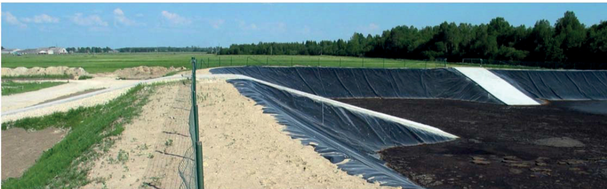
Kuva 10. Altaiden sedimentoituneen lieteen poistamiseksi altaaseen on rakennettu betonoitu ajoramppi altaan pohjalle saakka. Tällöin kaivurilla tai vastaavalla kumimattoa hellävaroin käsittelevällä koneella päästään sedimenttiä poistamaan, jotta allaskapasiteetti ei pienene liikaa, kuva Virossa.
