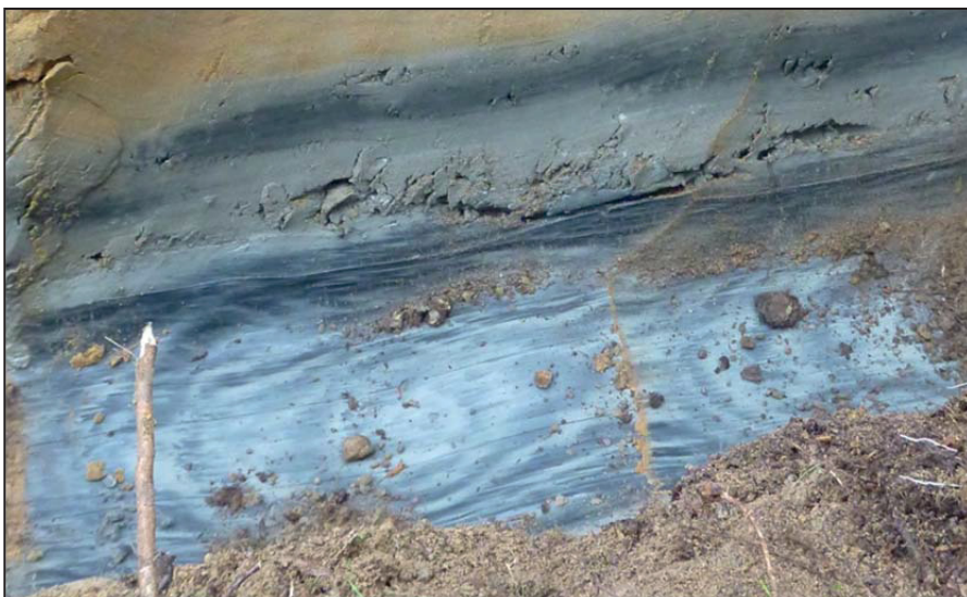
Kuva 7. Raidallista sulfidihiesua vesijohtokaivannon pohjalla Simossa. Kuva: Pentti Kouri
