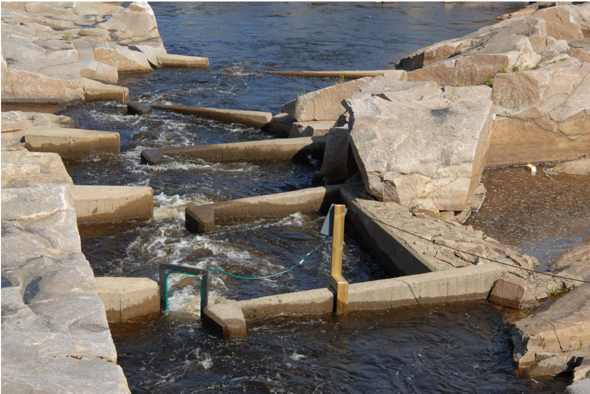
Kuva 17. Merikosken yläkalatien alaosaan asennettu PIT-antennijärjestelmä. Varsinainen antenni on kiinnitetty vanerikehikkoon, joka on asennettu kalatien pystyrakoon. PIT-lukija on puulankun päässä oleva harmaa laatikko. Laatikolta lähtee kaapeli tallentavalle tietokoneelle. Kuva: Panu Orell.
