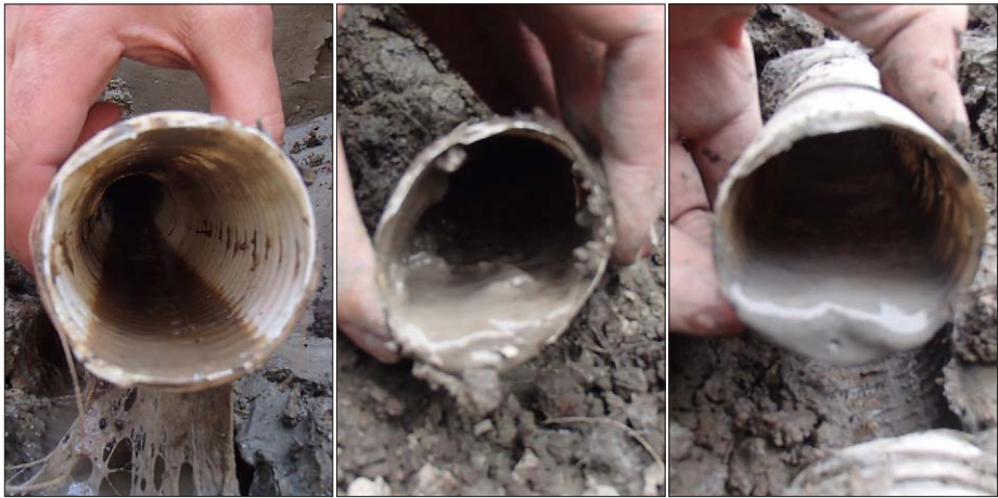
Kuva 3.50. Lieto. Lohkon kolmesta putkesta yksi oli puhdas. Kahteen putkeen pellon märällä alueella oli muodostunut liettymä.
