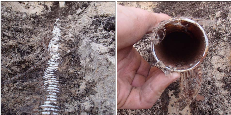
Kuva 3.53. Kalajoki. Suodatinkangas oli hajonnut lähes kokonaan. Kuva 3.54. Kalajoki 1–2. Putket olivat puhtaita maasta molemmilla lohkoilla. Ruostetta esiintyi paikoitellen paljon.
