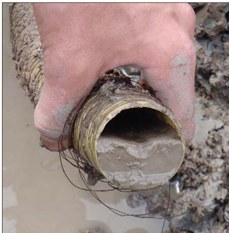
Kuva 3.61. Loviisa. Putkien tukkoisuus vaihteli merkittävästi lohkolla. Kuvassa eniten liettynyt putki.
