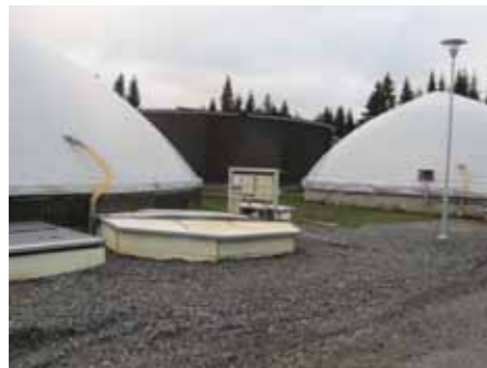
Juvan Bioson Oy:ssä lietelannan vastaanottosäiliö ja mädätteen varastosäiliö ovat vierekkäin lietteen purkamisen ja mädätteen kuormauksen optimoimiseksi. Taustalla biokaasulaitoksen reaktori. Kuva: Marjut Suontausta
